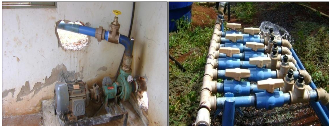
Figura 7. Fotos do conjunto motobomba e do cabeçal de controle do sistema de irrigação.
